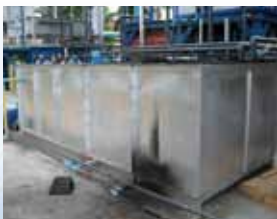
ถังพักน้ำเสีย (Buffer Tank)
